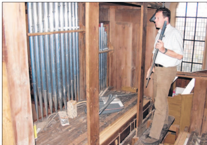
Schon seit Jahren sammelt Pfarrer Bernhard Schäfer Geld für die Sanierung der aus dem Jahr 1852 stammenden Orgel in der evangelischen Kirche Steinwenden. Jetzt haben die Restaurierungsarbeiten begonnen. —FOTO: RICHTER
